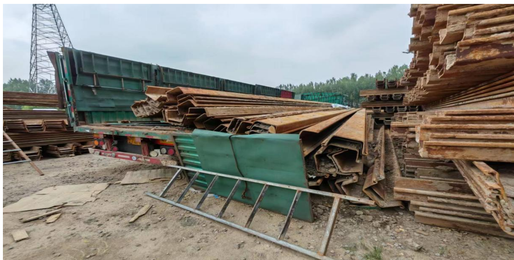
图4 钢板桩倒塌后图片
